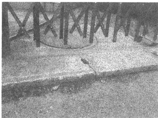
段差のある側溝
